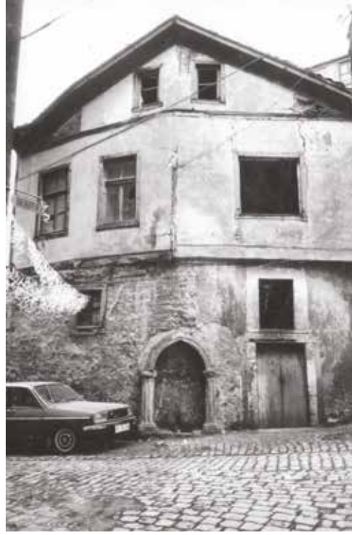
Foto 13. Çarşı Mahallesi Emin Alemdar Sokak'ta konut duvarında
